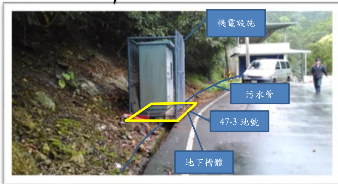
污水抽水站設施
